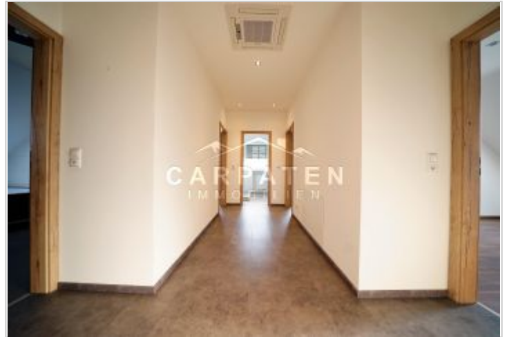
Flur DG mit Klimaanlage
